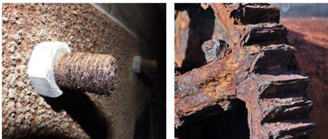
Сурет 2 - Металдардың коррозияға ұшырау түрлері
