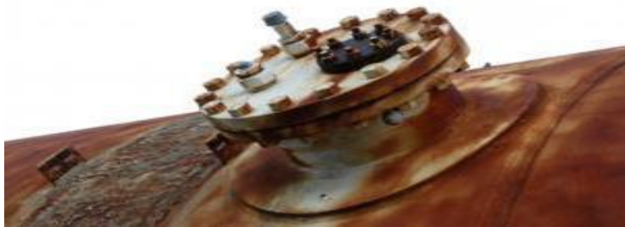
Сурет 1 - Металдардың коррозияға ұшырауы
